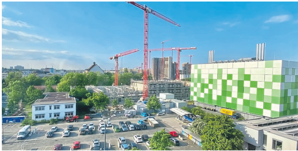
Das Rechenzentrum von Maincubes neben dem Gelände der Energieversorgung Offenbach: Rhein-Main ist Kernregion für Rechenzentren in Europa.
